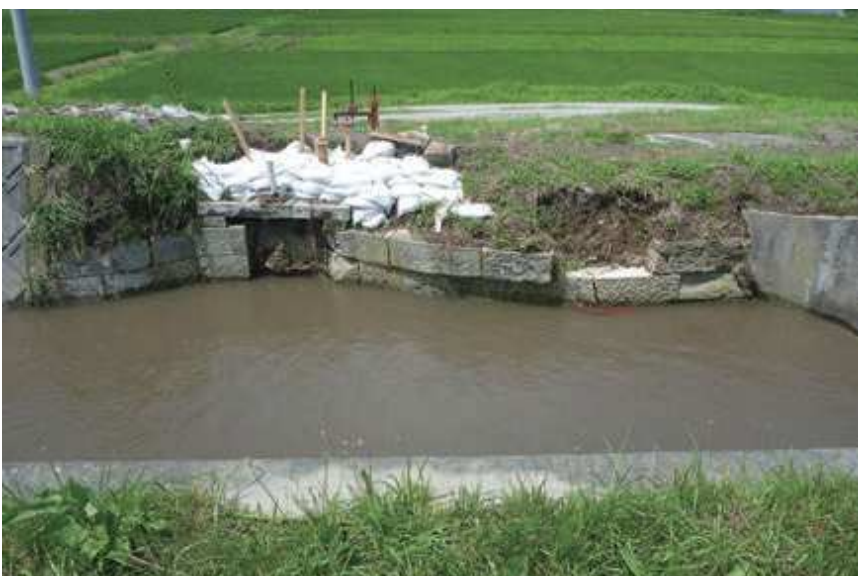
決壊した長崎堰取水口
