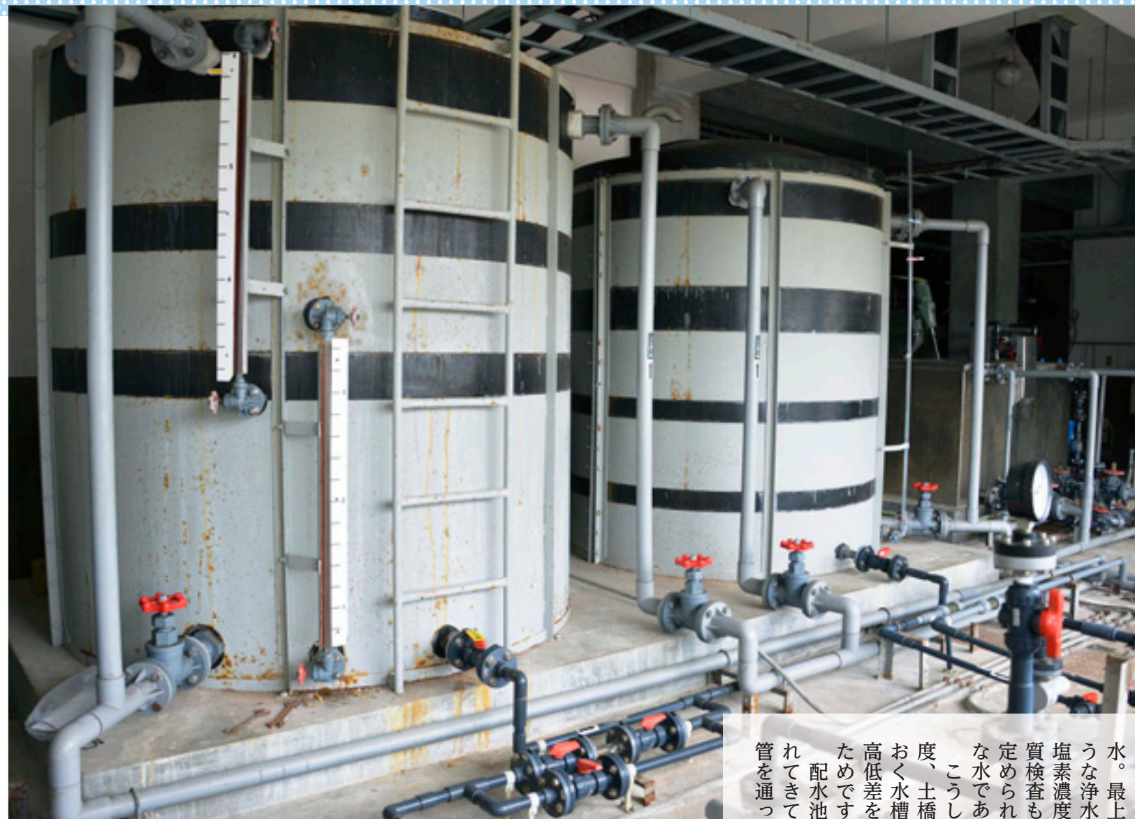
最上川中部水道企業団の薬品注入室
