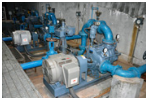
配水池に送水するポンプ
