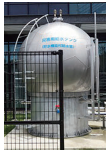
避難場所に設置された6 tの災害用給水タンク（熊本市上下水道局）
