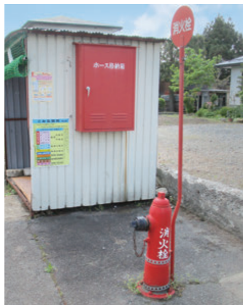
町のなかの消火栓 (新田町区内)
