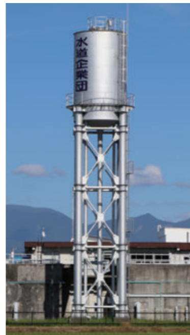
ろ過池を洗浄するための水を貯める高架タンク
