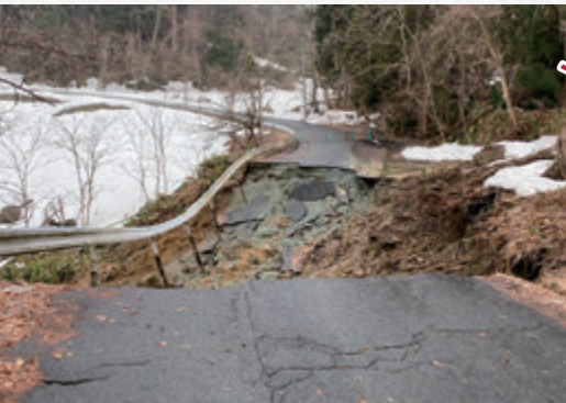
約30mにわたり道路が崩落 車も人も通れません
