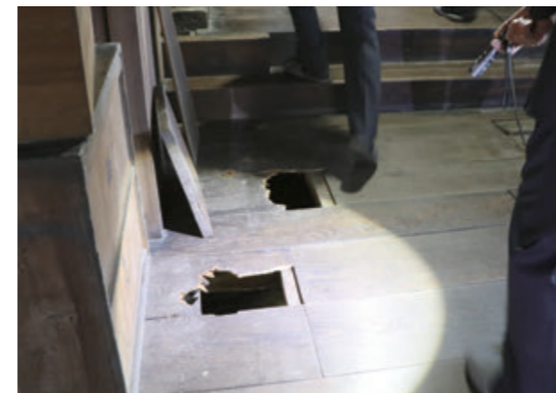
柏倉家の傷んだ床（令和3年5月12日視察時）
