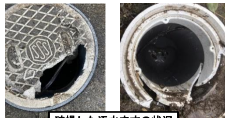
破損した汚水ますの状況
